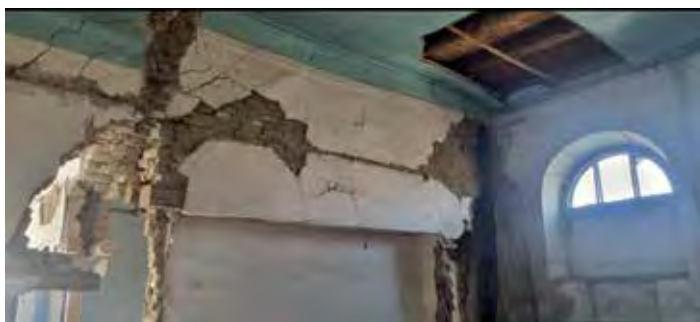
Рис. 7. Общий вид внутренней (южная часть центрального блока) обрушенной части (обрушена стена, перегородка) здания; покрытие здания состоит из деревянных балок и дощатого настила
