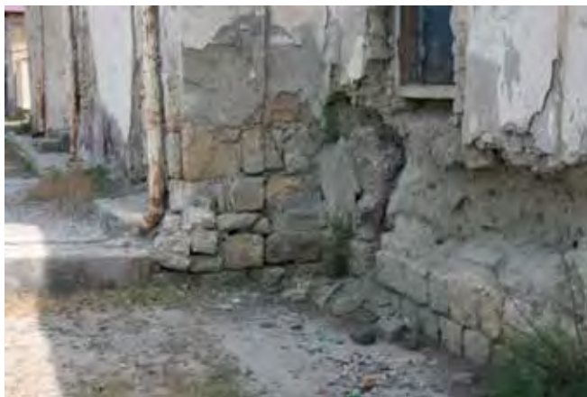
Рис. 4. Фрагмент стены главного фасада здания (ноябрь 2023 г.); конструкция фундамента из кладки известняковыми камнями не поврежденное, а наружная стена из сырцового кирпича почти полностью разрушена; угловой участок из каменной кладки поврежденное, водосточные трубы подвержены коррозии, отмостка по периметру разрушена, техническое состояние окна неудовлетворительное
