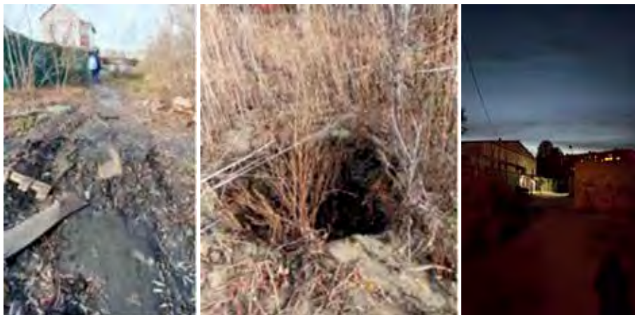
Рис. 3, 4. Отсутствие дорожного покрытия
