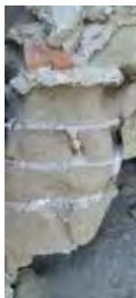
Рис. 5. Фрагмент наружной стены из сырцового кирпича (ноябрь 2023 г.); техническое состояние разрушенное и опасное
