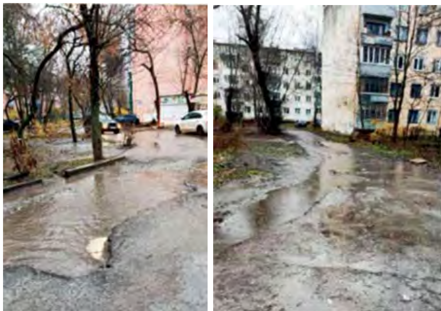
Рис. 6, 7. Дорожное покрытие ненадлежащего качества
