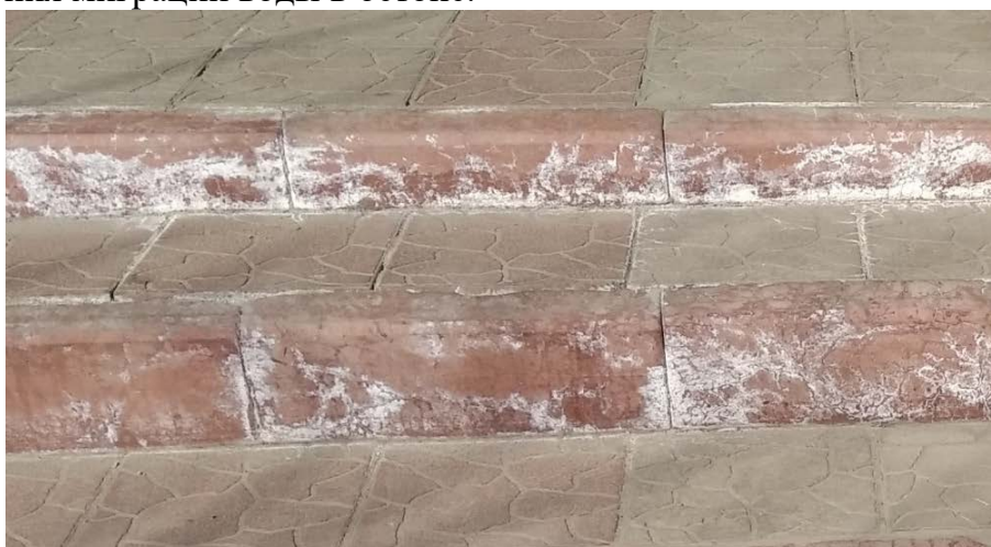
Рис. 2. Высолы на ступенях из объемно окрашенного бетона
