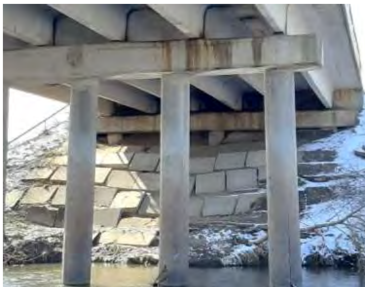
Рисунок 2 – Разрушение устоя моста
