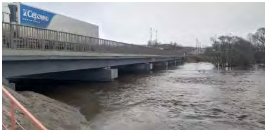
Рисунок 1 – Подтопление моста (весеннее половодье)
