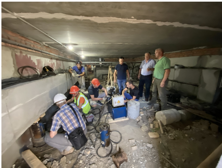
Усиление предаварийного жилого дома по ул. Новоселов, 113 в микрорайоне «Заря», г. Пенза (2021 год)
